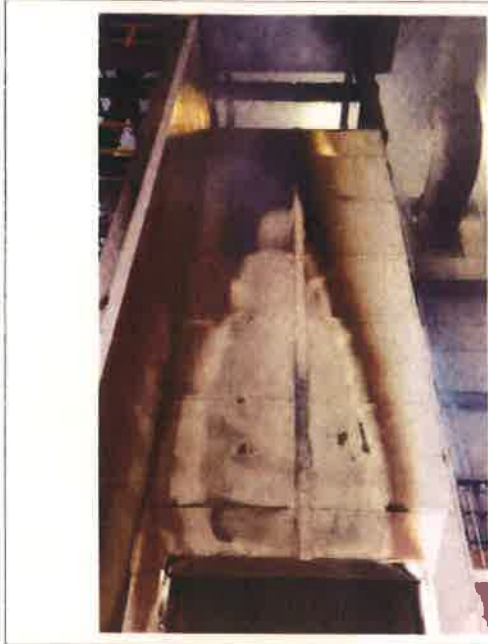
< 개구부 직상부 마감재 전체 탄화 상태(최소) >
